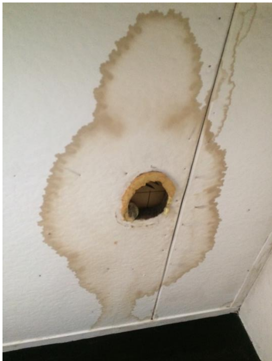
schade na renovatiewerkzaamheden: binnenschilderwerk is voor de huurder.
